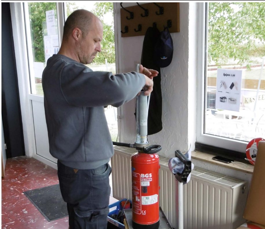
Jaarlijkse keuring van de brandblussers
