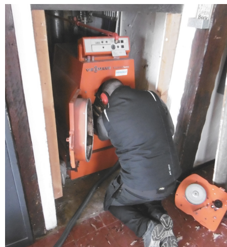
Onze verwarmingsketel werd op 07/04 gekuist door de firma Viessmann
