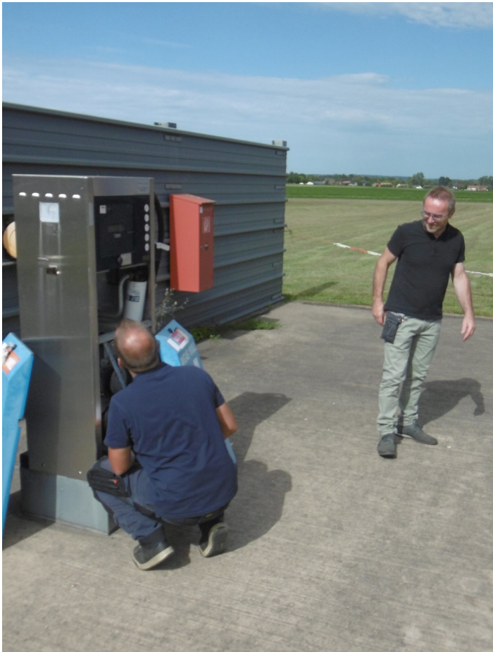
Keuring van de electriciteit van het fuelplatform door ATK
